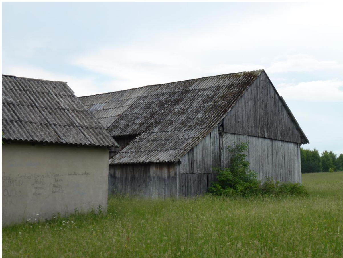
Rys. 9. Budynki gospodarcze pokryte azbestem falistym (Źródło: Fotografia własna)
