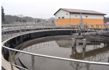
Oczyszczalnia ścieków w Sulęcinie – str. 1-2
