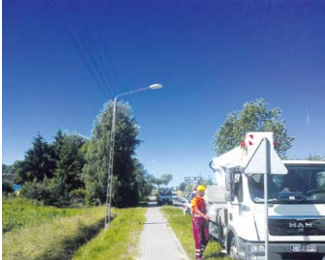
Nowa oprawa LED przy drodze wojewódzkiej
