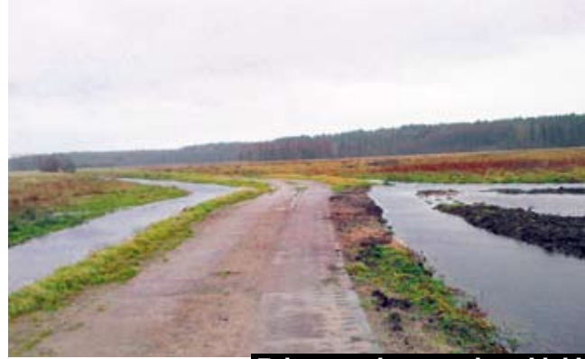
Zalewana droga gminna i łąki
