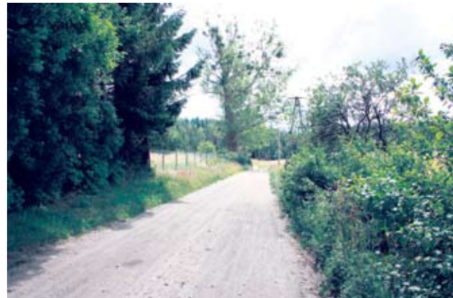
Nierówności zostaną zniwelowane
