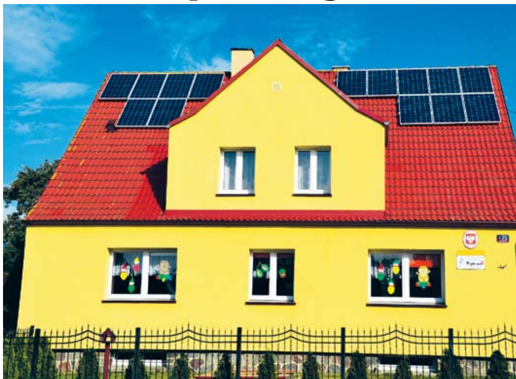
Ogniwa fotowoltaiczne zamontowane na dachu Wiejskiego Ogniska Przedszkolnego „Pajacyki” w Warszowie
