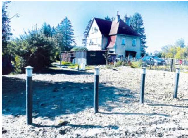
Oczyszczalnia przydomowa w Żukowie
