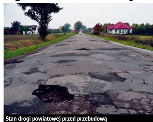
Stan drogi powiatowej przed przebudową
