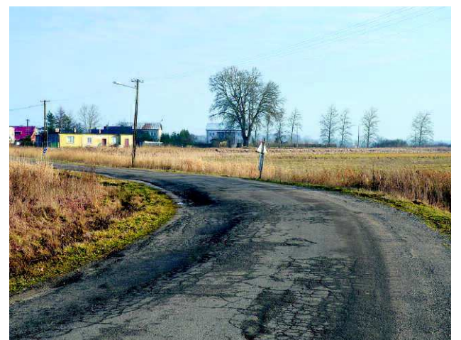
■ WYRWY I ZAŁOMY W ASFALCIE
