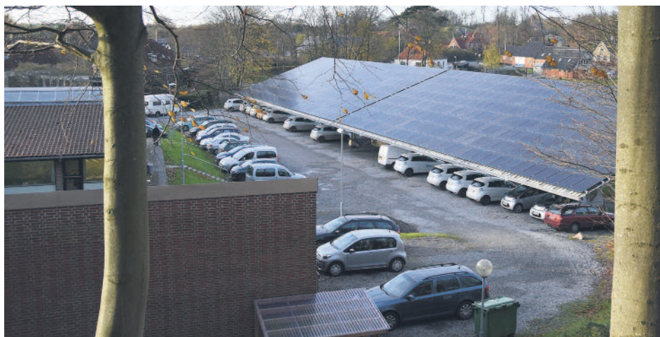
INSTALACJA FOTOWOLTAICZNA PRZY URZĘDZIE GMINY W SAMŚÓ I STACJA ŁADOWANIA SAMOCHODÓW ELEKTRYCZNYCH.
