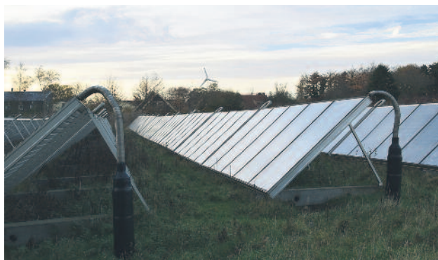
Farmy kolektorów słonecznych przy ciepłowni w Samsø
