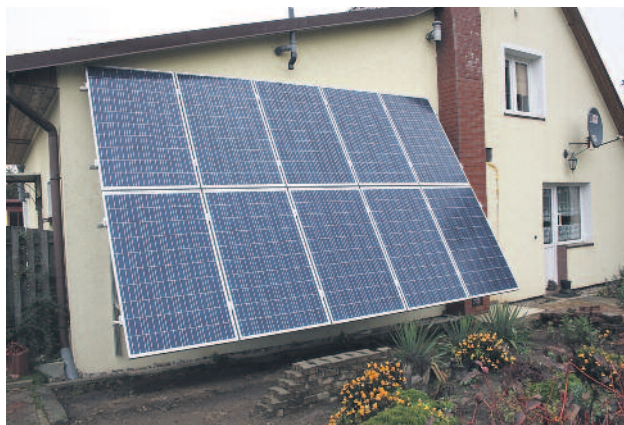
■ ZAINSTALOWANE OGNIWA FOTOWOLTAICZNE
