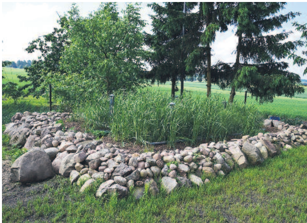
■ JEDNA Z WYBUDOWANYCH OCZYSZCZALNI ŚCIEKÓW
