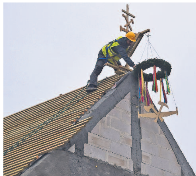
WIECHA ZAWISŁA NA BUDYNKU SZKOLNYM 25 PAŹDZIERNIKA 2016 R.
