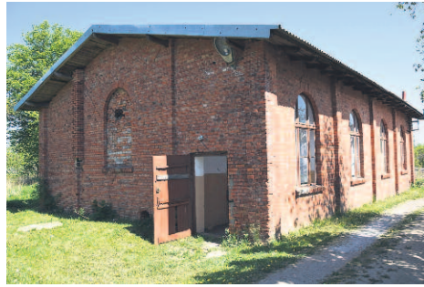
■ ŚWIETLICA DO REMONTU - STARY KRAKÓW
