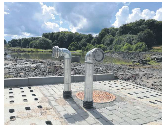
PUNKT CZERPIANIA WODY W ŻUKOWIE
