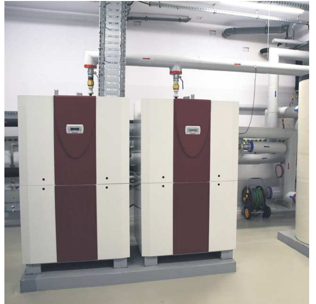
Nowoczesna kotłownia z pompami ciepła zapewnia komfortowe warunki dla uczniów
