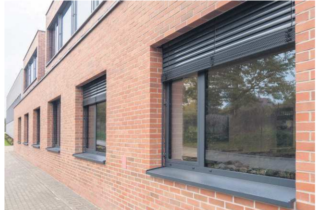
AUTOMATYCZNE ŻALUZJE FASADOWE REGULUJĄ DOPŁYW ŚWIATŁA I CIEPŁA
