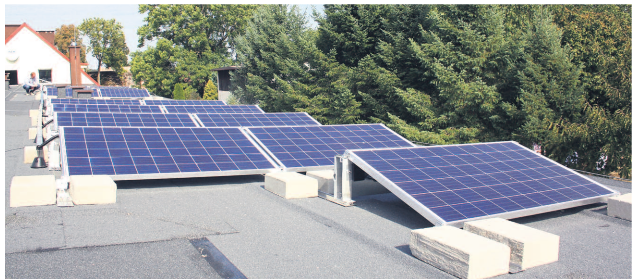
■ PANELE FOTOWOLTAICZNE NA PRZEDSZKOLU W GWIAZDOWIE
