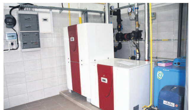
POMPY CIEPŁA WRAZ Z ISTNIEJĄCYM WCZEŚNIEJ KOTŁEM W SZKOLE W WARSZKOWIE ZAPEWNIĄ CIEPŁO NA POTRZEBY PLACÓWKI
