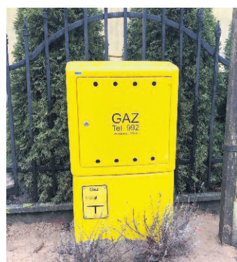
SKRZYNIKA PRZYŁĄCZENIOWA PRZY PRZEDSZKOLU W WARSZKOWIE
