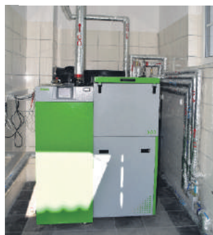
Nowoczesna kotłownia na pellet ogrzewa budynek
