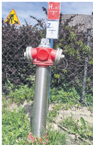
Estetyczne hydranty ustawiono w trosce o bezpieczeństwo p.poż. mieszkańców
