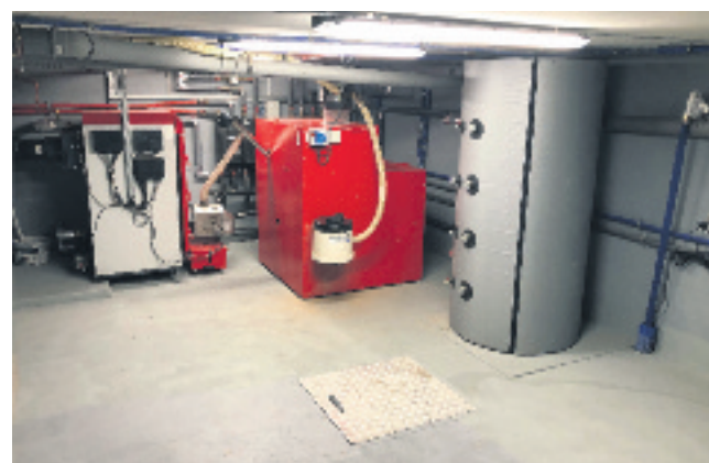
Nowoczesne wyposażenie odnowionej kotłowni
