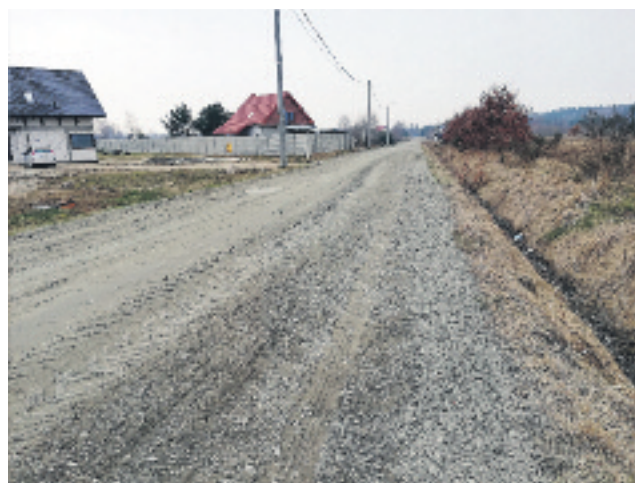
Droga na kolonii we Wrześnicy nie spełnia oczekiwań mieszkańców. Nawierzchnia z kruszywa wymaga stałego uzupełniania i napraw
