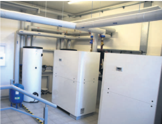
Nowoczesna kotłownia w Szkole Podstawowej we Wrześnicy
