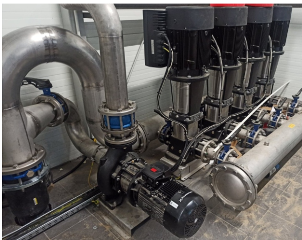
Zmodernizowana Stacja Uzdatniania Wody w Bielsku
