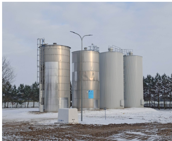
Zmodernizowana Stacja Uzdatniania Wody w Bielsku
