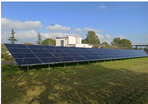
Panele Fotowoltaiczne przy Oczyszczalni Ścieków w Bielsku
