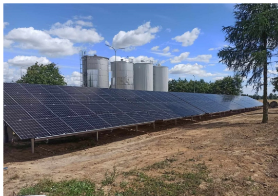
Panele Fotowoltaiczne przy SUW w Bielsku
