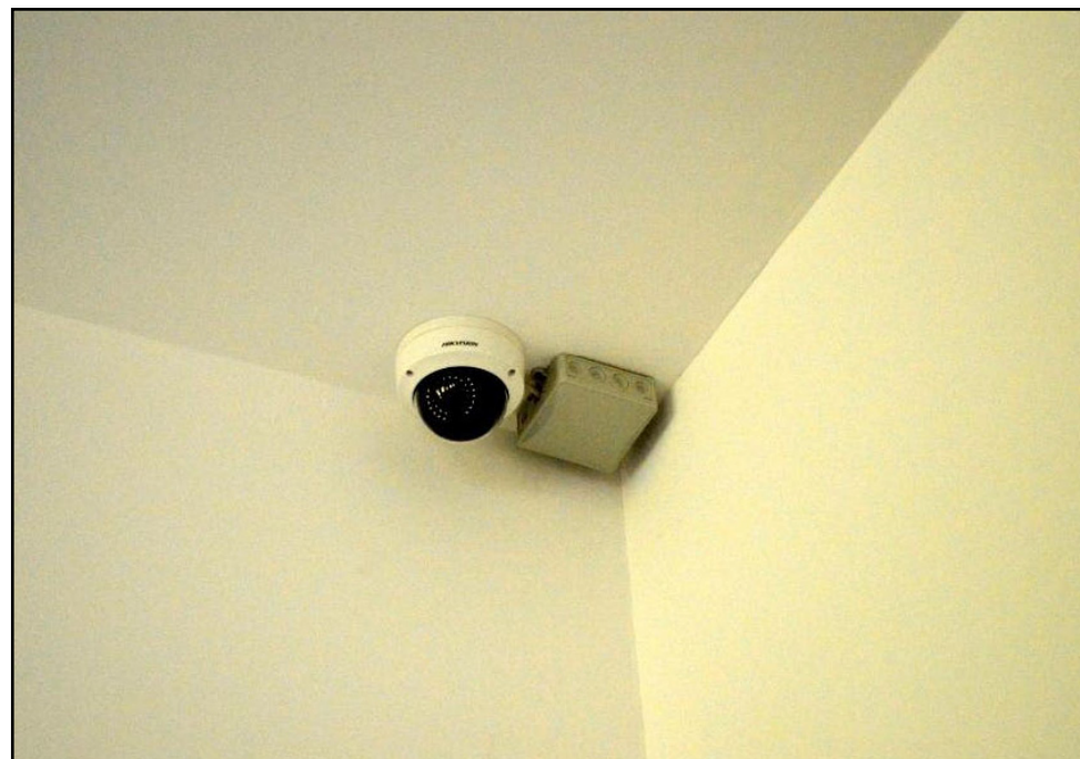
Monitoring zapewnia pełne bezpieczeństwo w obiekcie.
