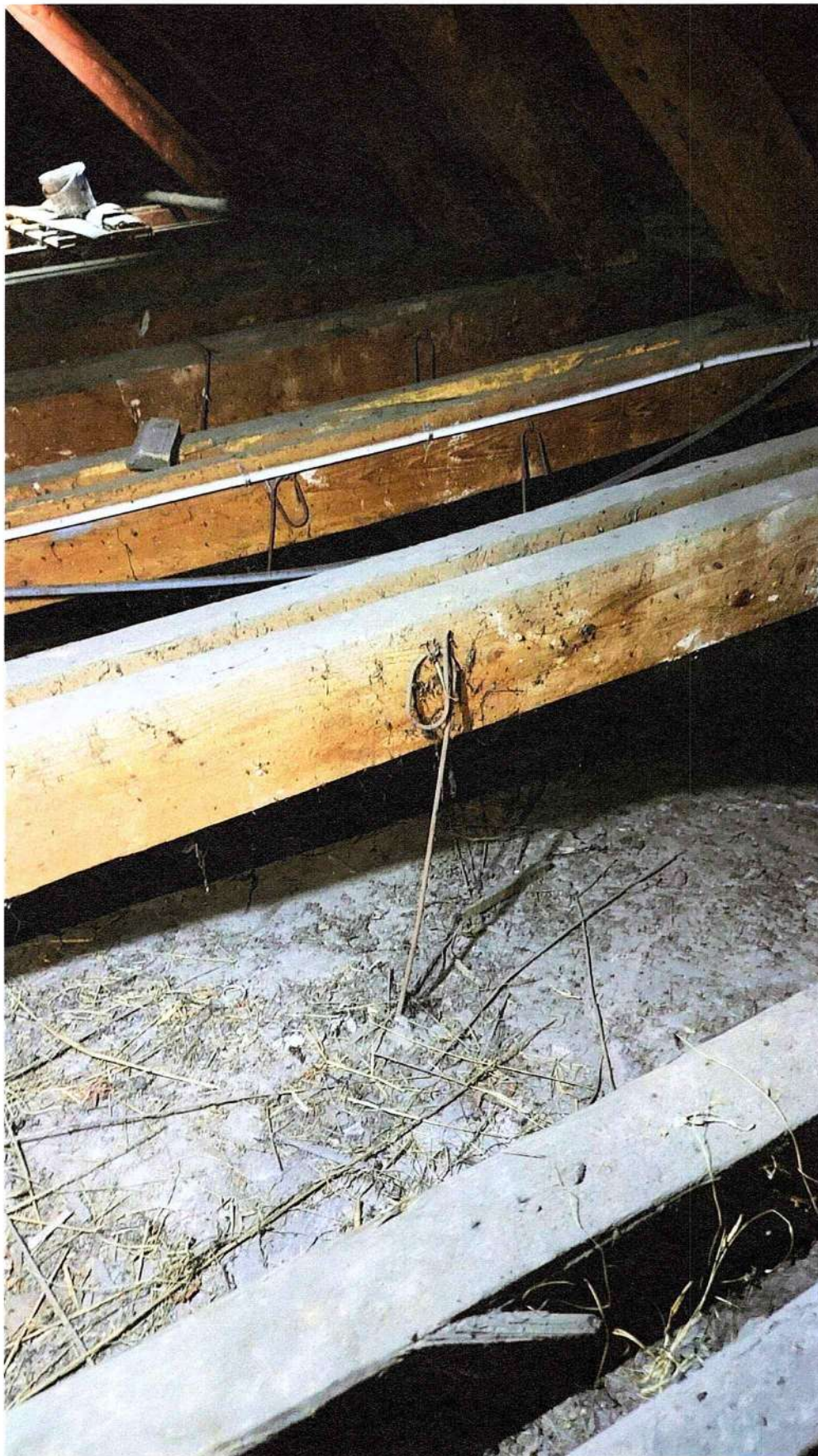
WIDOK BELEK STROPOWYCH ORAZ WIDOCZNA ICH KORODZJA
