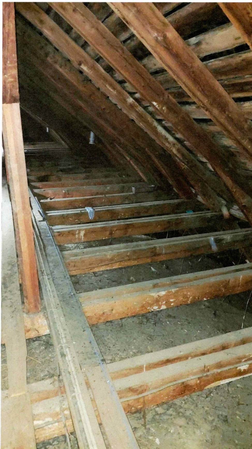
WIDOK BELEK STROPOWYCH ORAZ WIDOCZNA ICH KOROZJA
