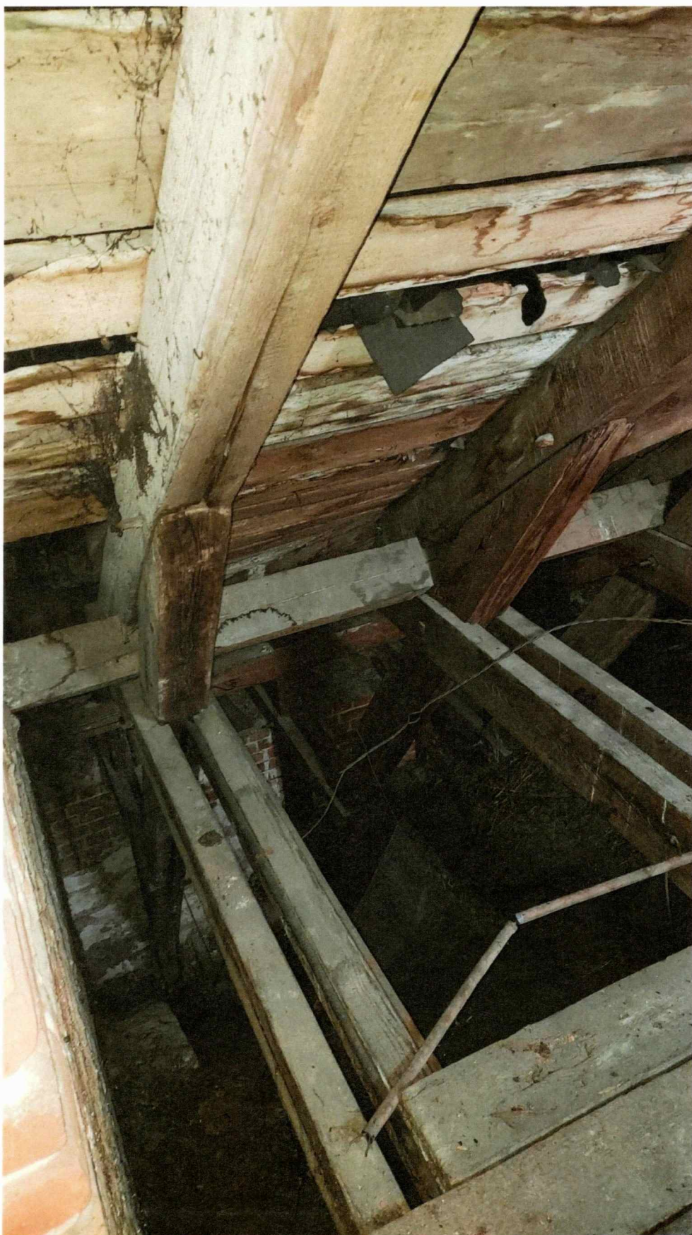
WIDOCZNE ZACIEKI NA DESKOWANIU POŁACI DACHU
