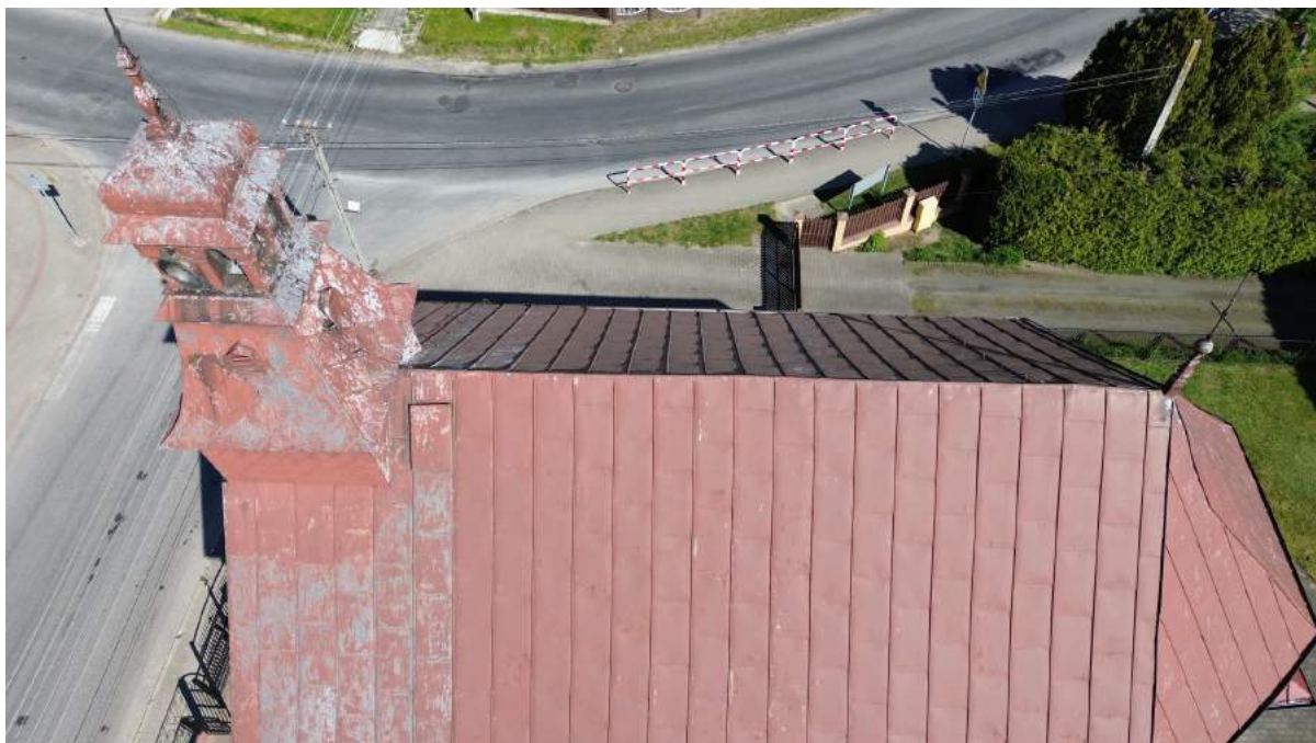
Fot. nr 5 Widok na dach kościoła i wieżę – widoczna postępująca degradacja pokrycia wieży kościoła i pokrycia dachu
