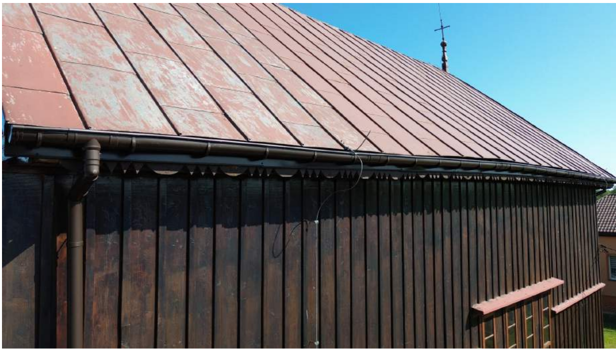
Fot. nr 10 Widok na dach kościoła– widoczna postępująca degradacja i pokrycia dachu
