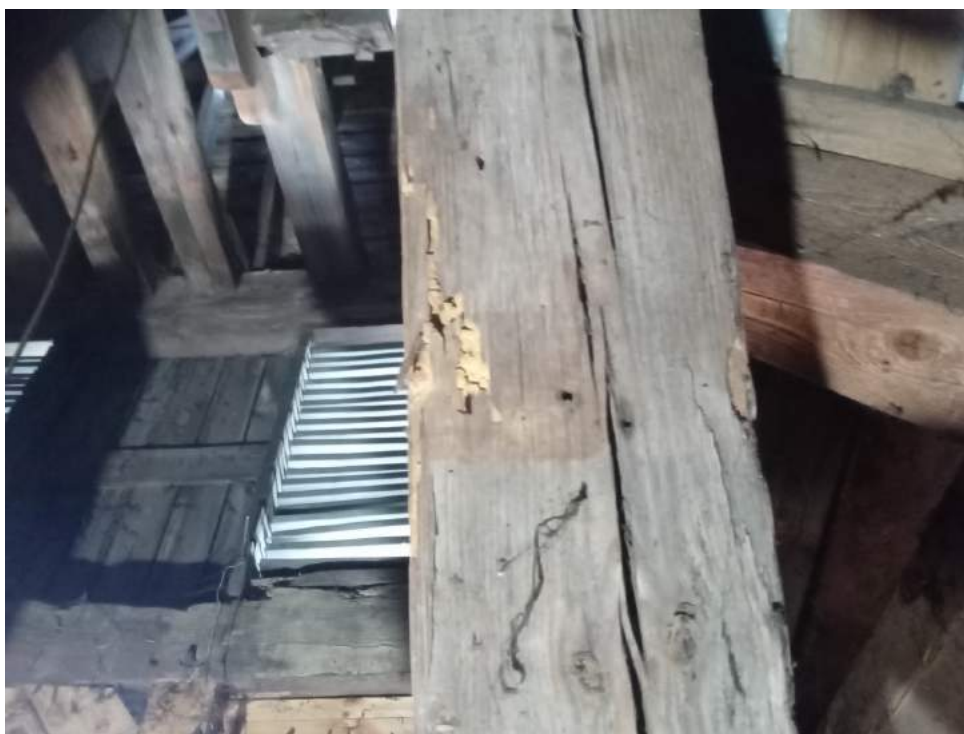
Fot. nr 17 Widoczna zgnilizna drewna na słupie wsporczym konstrukcji wieży
