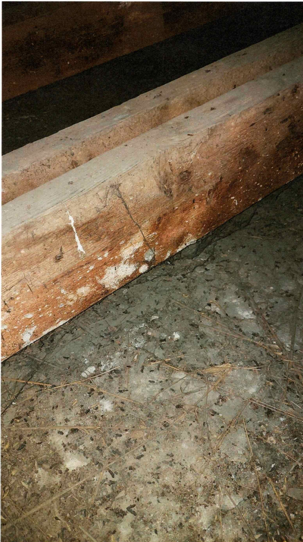
WIDOCZNA KOROZJA BIOLOGICZNA NA BELKACH STROPOWYCH
