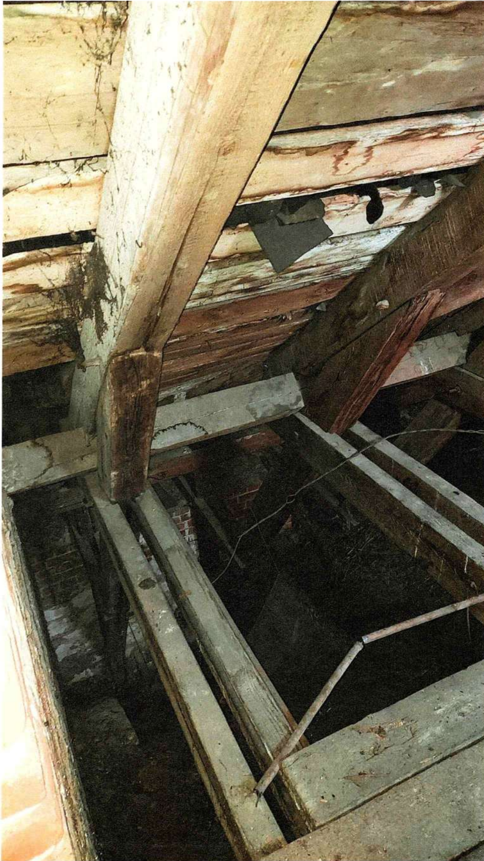
WIDOCZNE ZACIEKI NA DESKOWANIU POŁĄCI DACHU
