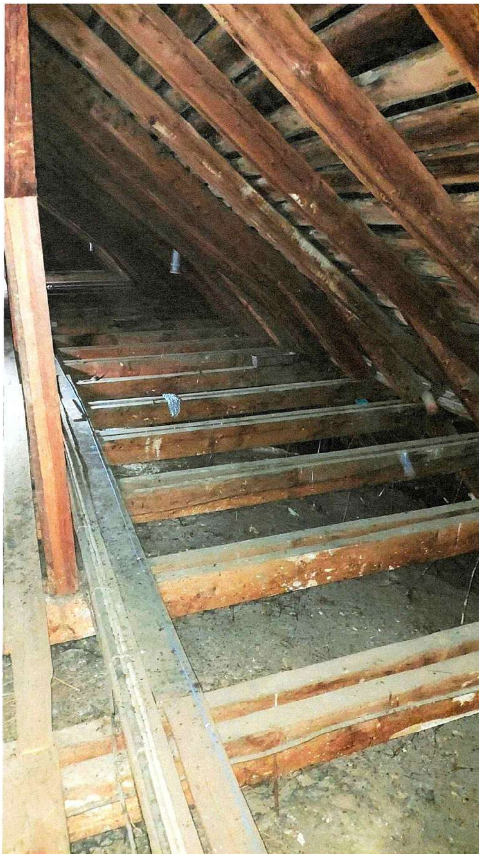
WIDOK BELEK STROPOWYCH ORAZ WIDOCZNA ICH KOROZJA
