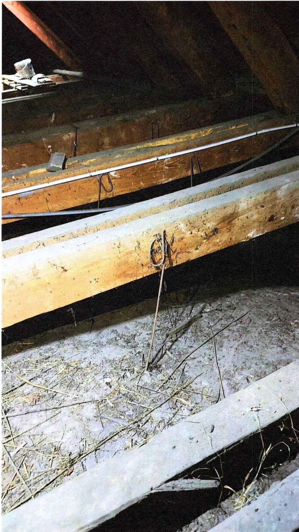
WIDOK BELEK STROPOWYCH ORAZ WIDOCZNA ICH KORODZJA
