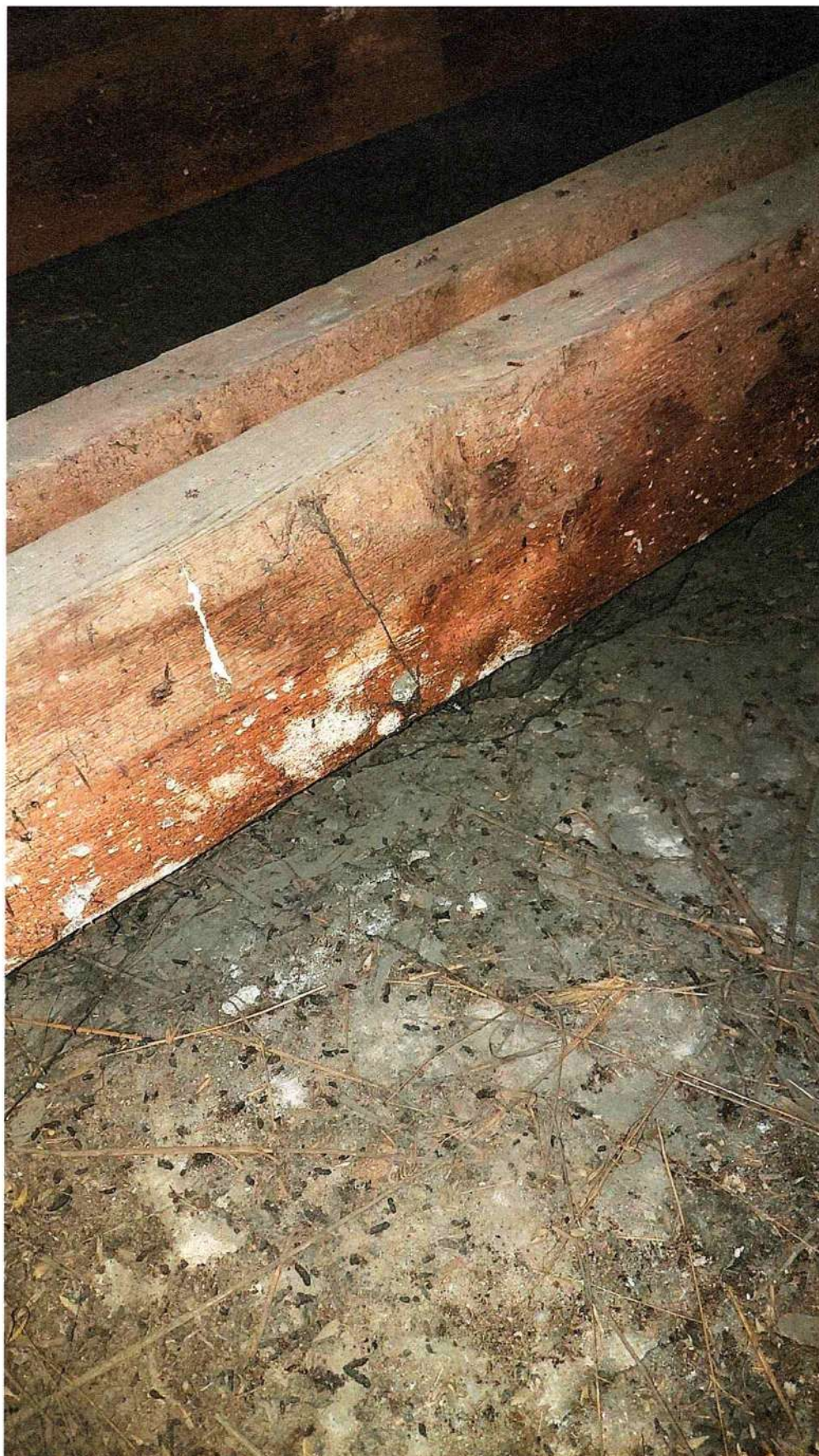
WIDOCZNA KOROZJA BIOLOGICZNA NA BELKACH STROPOWYCH
