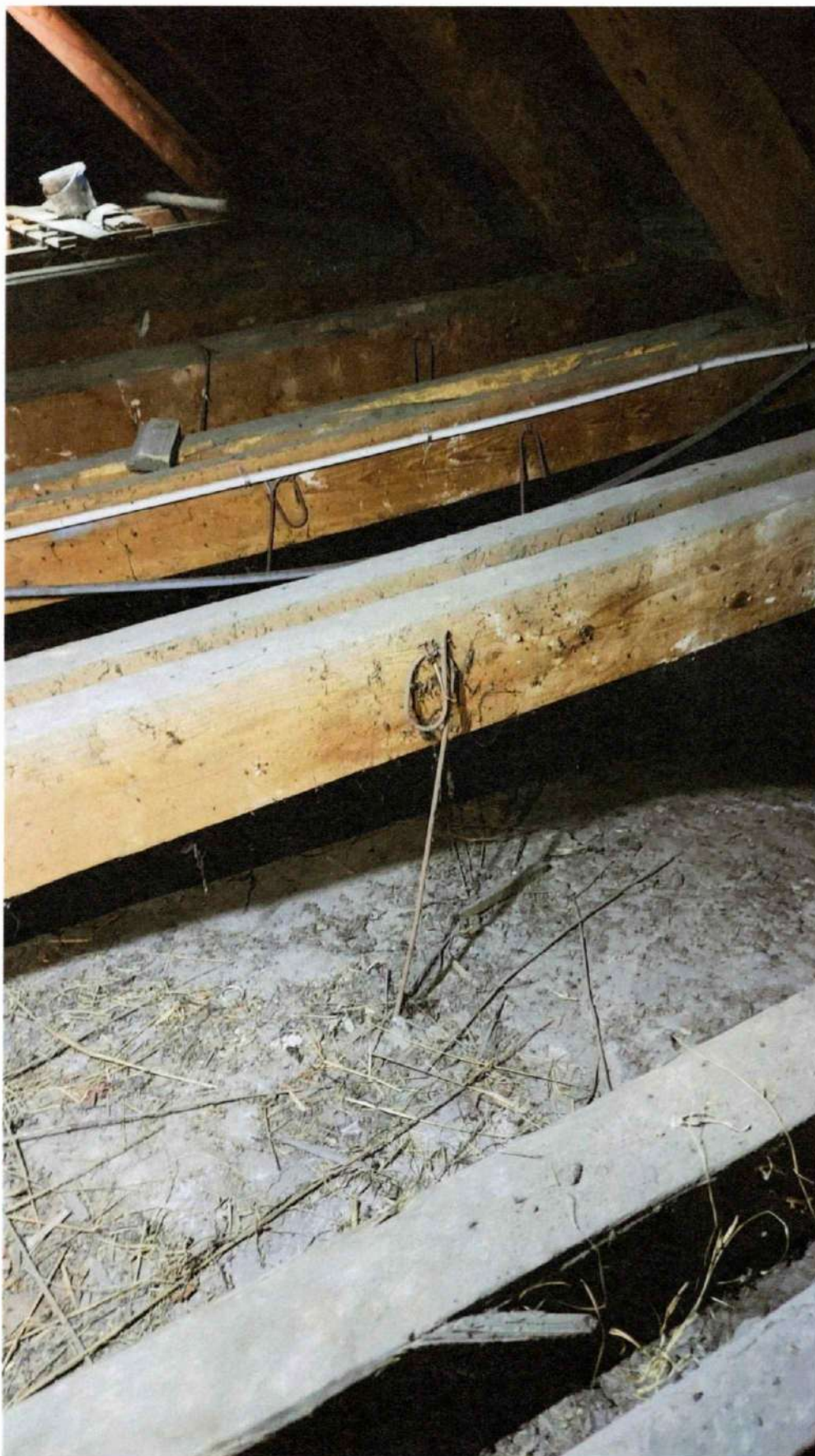
WIDOK BELEK STROPOWYCH ORAZ WIDOCZNA ICH KOROZJA
