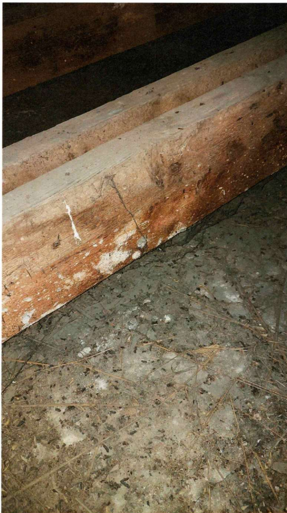
WIDOCZNA KOROZJA BIOLOGICZNA NA BELKACH STROPOWYCH
