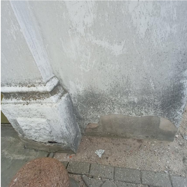
Fot.12. kościół par. p.w. św. Andrzeja w Złoczewie, partie przyziemia – zatarcia cementowe pochodzące z szóstej fazy chronologicznej.
