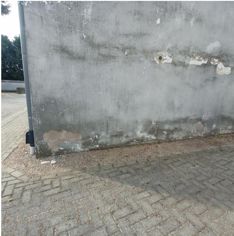
Fot. 40. kościół par. p.w. św. Andrzeja w Złoczewie, uszczelnienie powierzchni ścian przez czarne, zwarte nawarstwienia od strony północnej i południowej.
