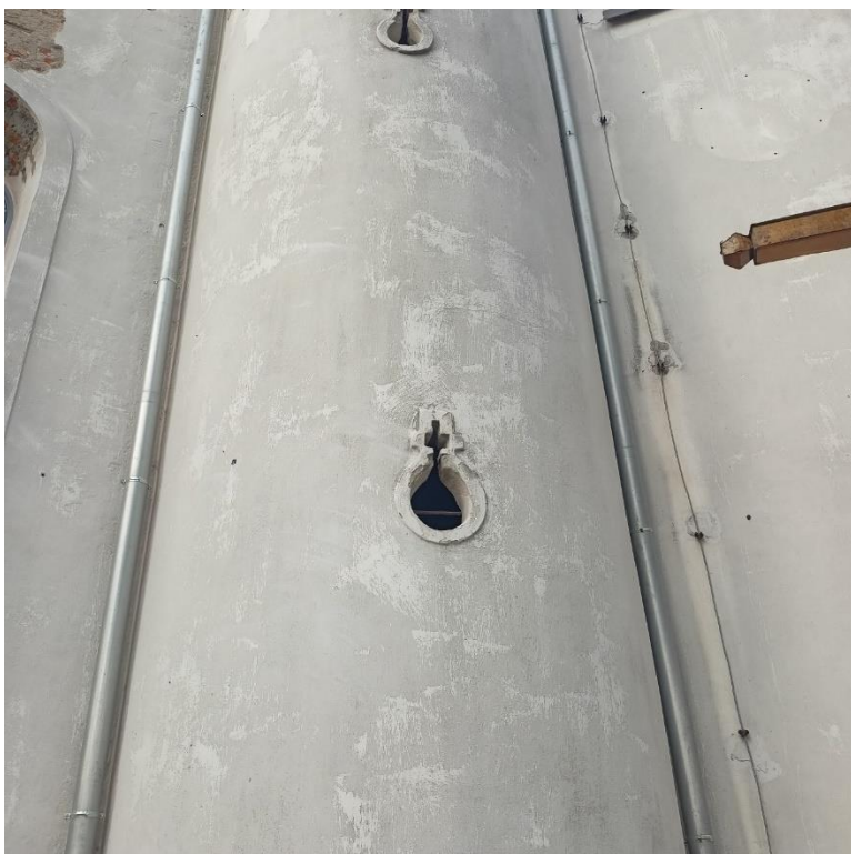
Fot.35. kościół par. p.w. św. Andrzeja w Złoczewie, spękania i wykruszenia tynku w obrębie zamontowanego piorunochronu.
