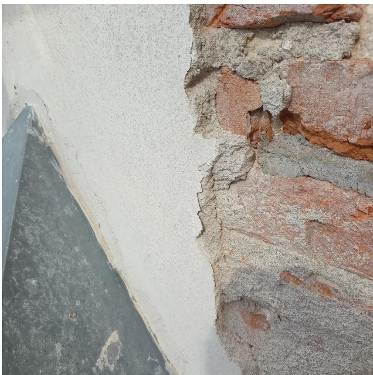
Fot.18. kościół par. p.w. św. Andrzeja w Złoczewie. Wtórna warstwa tynku na wątku muru. Brak historycznych powłok tynkarskich.
