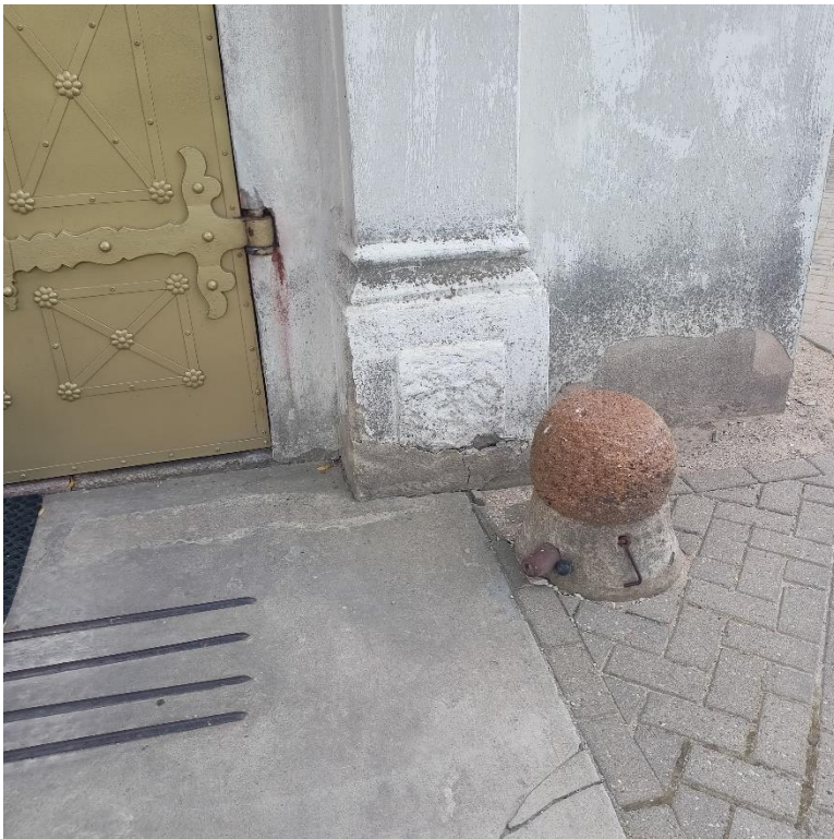
Fot.33. kościół par. p.w. św. Andrzeja w Złoczewie, wejście główne w elewacji zachodniej. Obluzowane i spękanne fragmenty tynku w partii przyziemia spowodowane utratą właściwości mechanicznych wątku pokrytego silnymi zaprawami cementowymi.
