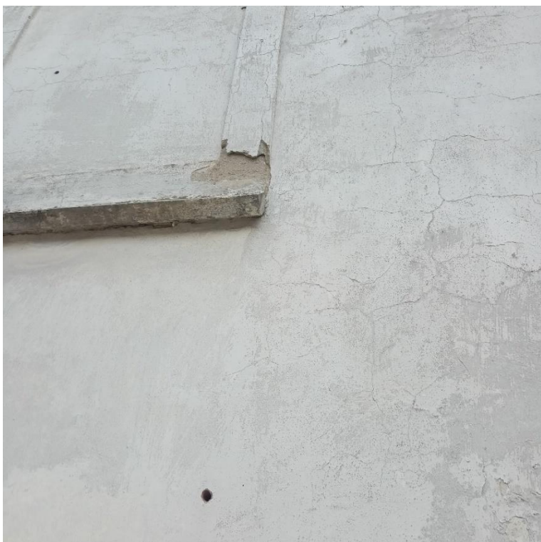
Fot.46. kościół par. p.w. św. Andrzeja w Złoczewie, zniszczenia – rozwarstwienia tynku w miejscach dekoracji architektonicznych.
