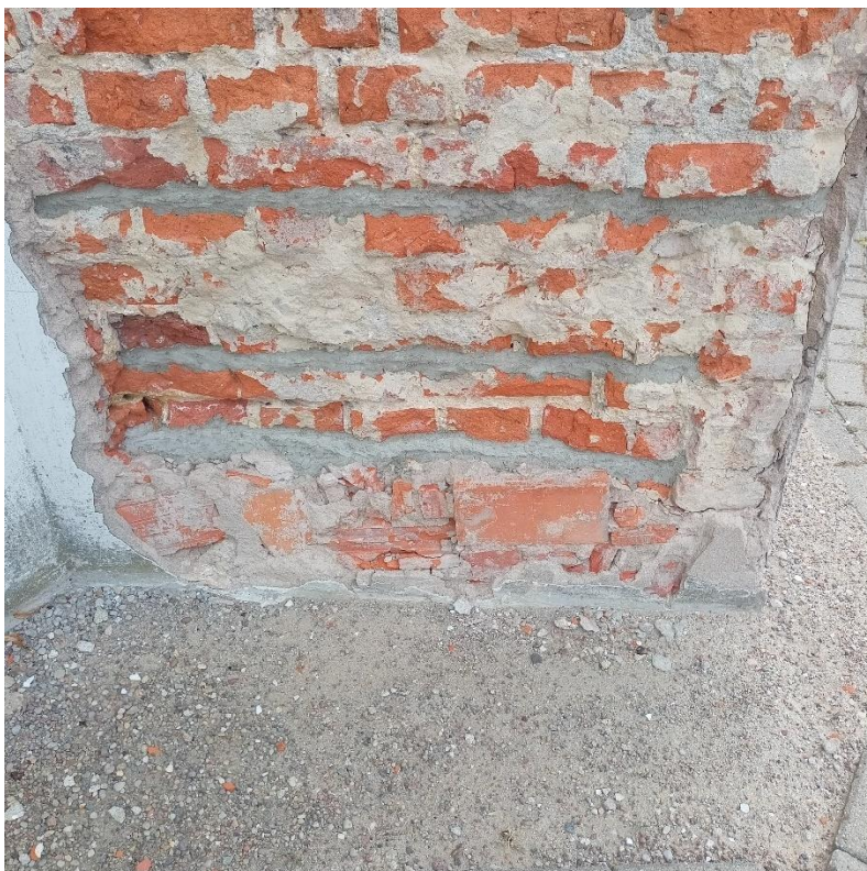
Fot.30. kościół par. p.w. św. Andrzeja w Złoczewie, uzupełnienia w wątku muru na skutek erozja oryginalnej cegły spowodowana brakiem wzmocnienia wątku i niewłaściwym fugowaniem przed zabiegiem współczesnego potynkowania.
