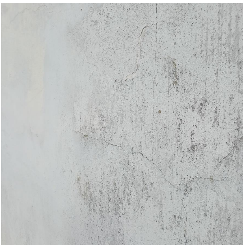
Fot. 44. kościół par. p.w. św. Andrzeja w Złoczewie, elewacje zewnętrzna z brudną i spękaną odpadającą powłoką farby.
