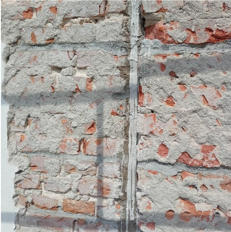
Fot.32. kościół par. p.w. św. Andrzeja w Złoczewie. Nasieki i uszkodzenia mechaniczne na wątku ceglanym wskutek zbijania i nakładania kolejnych warstw tynku.
