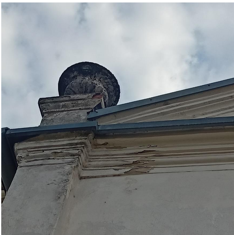
Fot.34. kościół par. p.w. św. Andrzeja w Złoczewie, skutki spływającej na ściany wody z pokrycia dachowego, uszkodzenia warstwy tynkarskiej i malarskiej.
