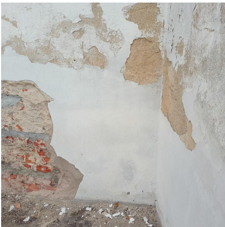
Fot. 45. kościół par. p.w. św. Andrzeja w Złoczewie, zniszczenia partii przyziemia: osłabienie właściwości mechanicznych podłoża, niewłaściwe fugi, rozwój mikroflory, rozwarstwienia tynku.
