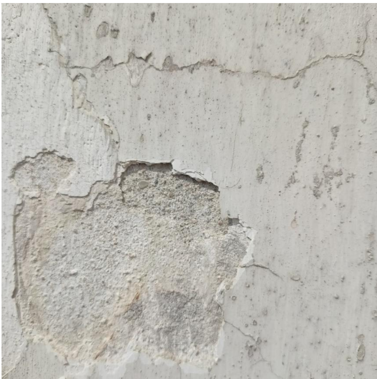
Fot.13. kościół par. p.w. św. Andrzeja w Złoczewie, elewacja zewnętrzna w górnej partii. Gruba powłoka białych farb pochodzących z różnych faz chronologicznych.
