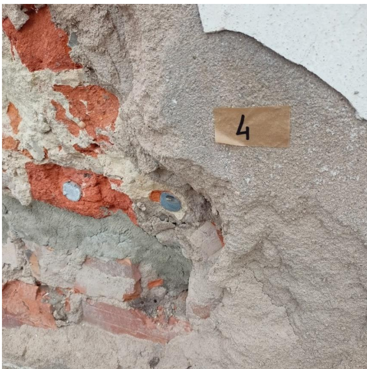
Fot.8. kościół par. p.w. św. Andrzeja w Złoczewie, odkrywka naturalna w partii przyziemia. Obecność warstwy mającej pełnić zadanie izolacji hydrofobowej (4) – wykonane w celach ratunkowych – czwarta faza chronologiczna.
