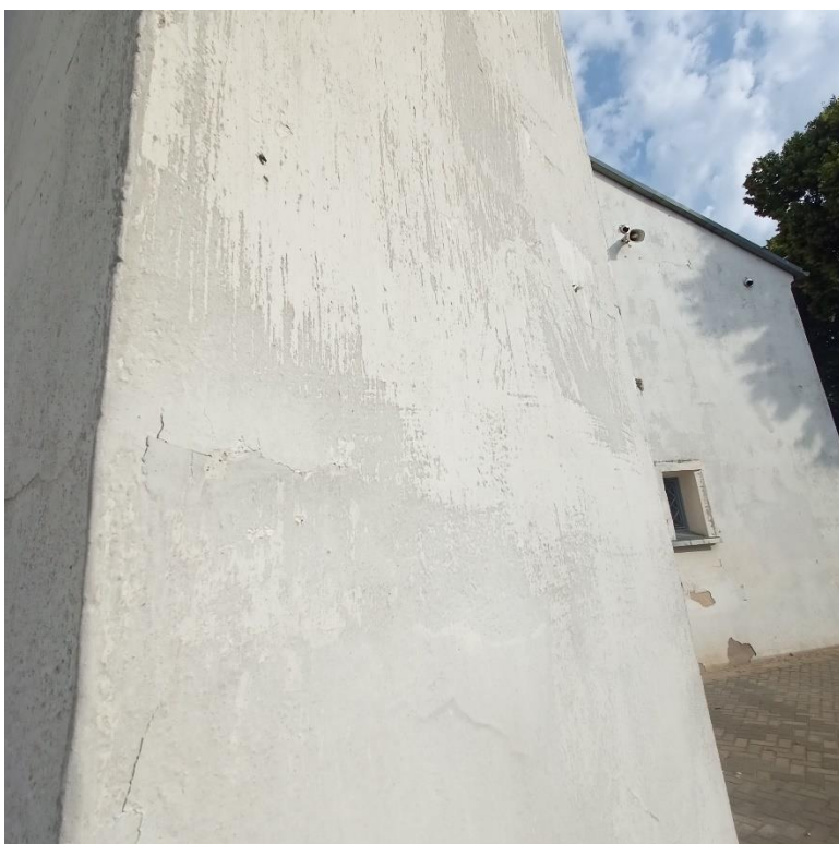
Fot.39. kościół par. p.w. św. Andrzeja w Złoczewie. Zniszczone warstwy farby pokrywającej tynk. Złuszczenia warstwy emulsyjnej, zabrudzenia i spękania warstw wapiennych.
