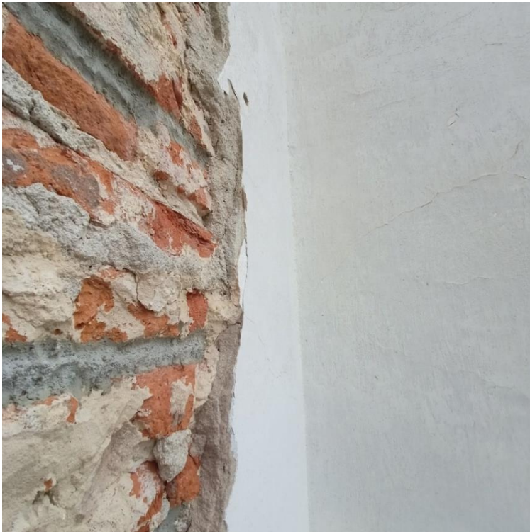
Fot.1. kościół par. p.w. św. Andrzeja w Złoczewie, strefa przyziemia elewacji zewnętrznej, układ współczesnych warstw tynkarskich. Celem odkrywek było stwierdzenie, czy na ścianie występują wcześniejsze warstwy.
