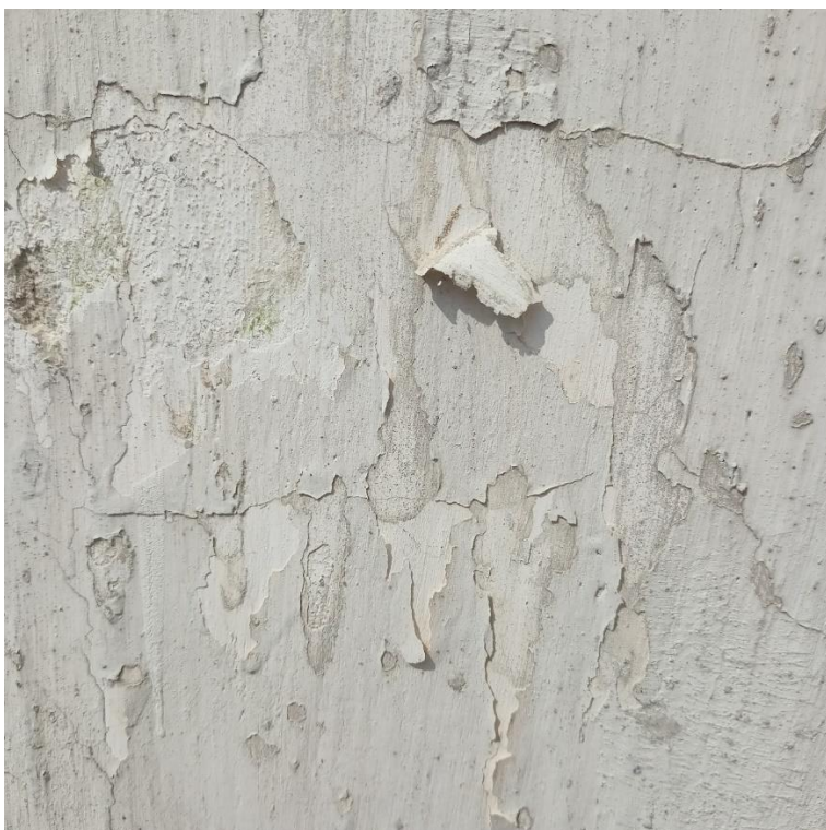
Fot.14. kościół par. p.w. św. Andrzeja w Złoczewie, warstwy białych farb dekorujących tynk na przestrzeni ostatniej ćwierci XX w. i współcześnie. Zewnętrzne emulsyjne powłoki zakrywają porażoną mikrobiologicznie (zielonkawy odcień) i pokrytą zabrudzeniami wapienną farbę.
