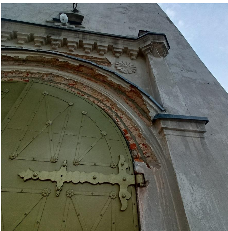
Fot.47. kościół par. p.w. św. Andrzeja w Złoczewie, zniszczenia profili sztukatorskich w skutek współczesnych napraw wążku muru.
