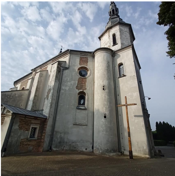
Fot.26. kościół par. p.w. św. Andrzeja w Złoczewie, elewacja od strony północnej. Ściany kościoła pokryte warstwą zanieczyszczeń biologicznych oraz zabrudzeniami powierzchniowymi. Spękania tynku, odsłonięte partie muru w miejscach iniekcji ratunkowych.
