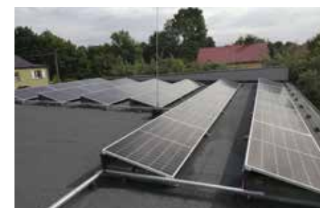
Panele fotowoltaiczne na budynku UG Damnica
