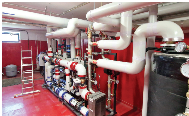
Nowy węzeł cieplny zmniejszy koszty energii ogrzewania wody i powietrza w budynku
