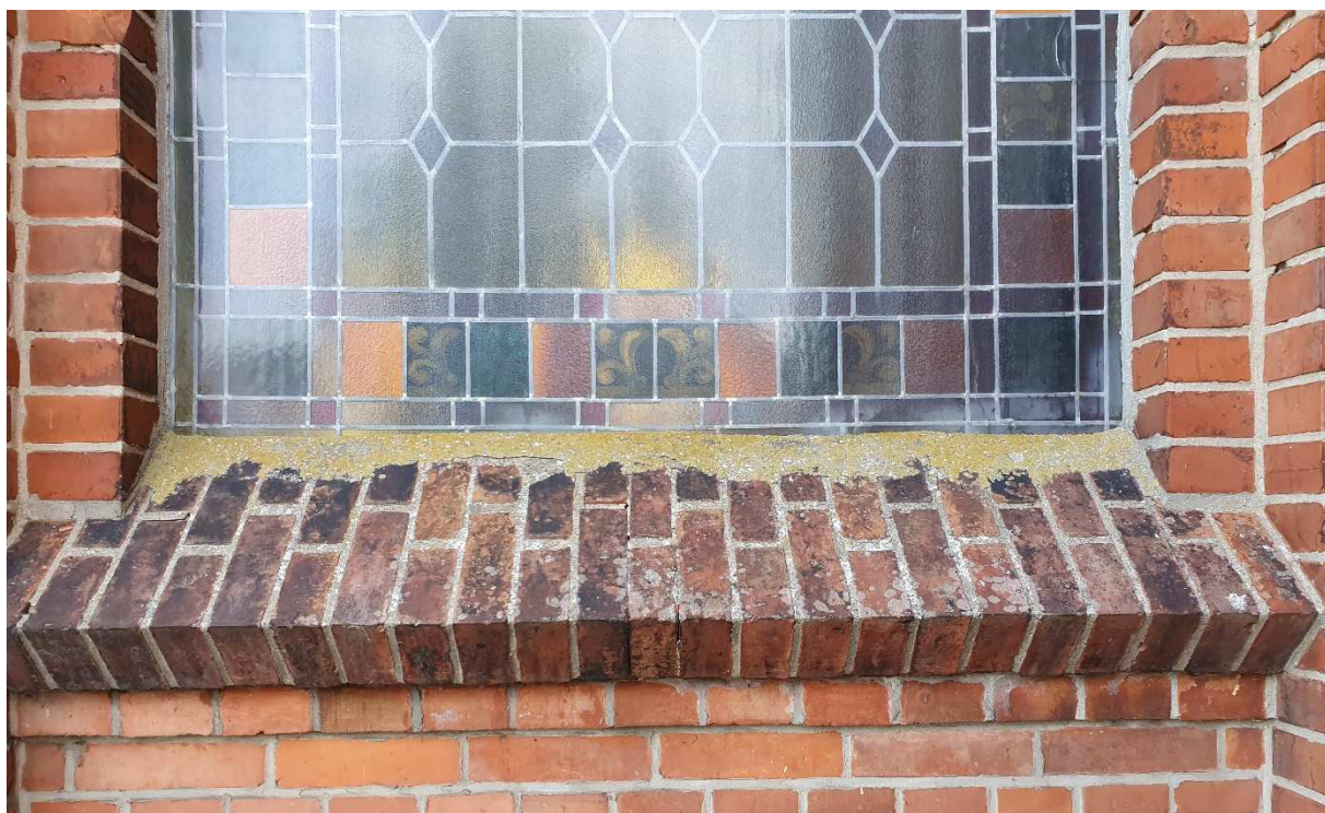
Fot.10. Łążyn, kościół pw. św. Walentego. Miejscowo, na parapetach widoczne są kolonie złocistych porostów.
