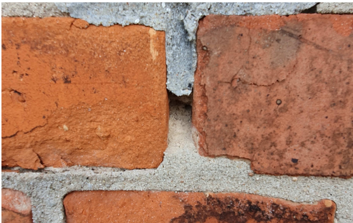
Fot.8. Łążyn, kościół pw. św. Walentego. Fragment wątku ceglanego. Na zdjęciu widoczna odkrywka spoinu ukazująca materiał oryginalny w jasno-piaskowym odcieniu.
