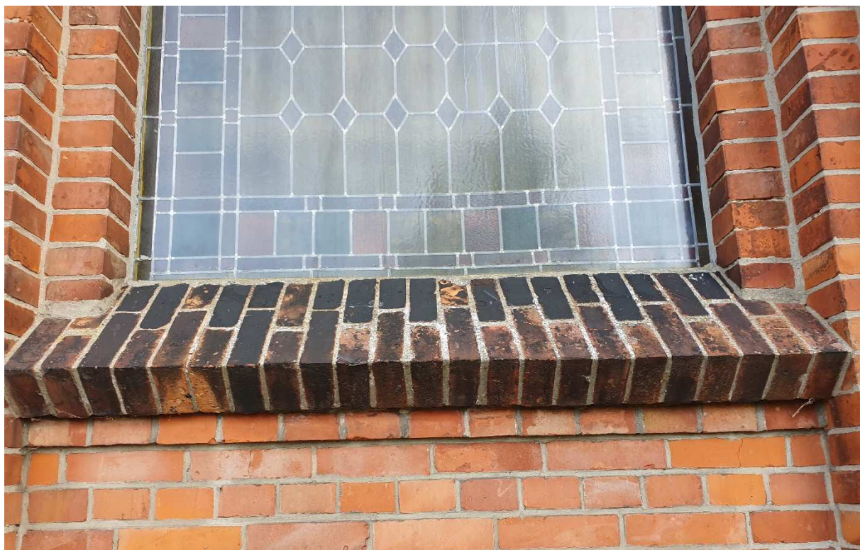
Fot.9. Łążyn, kościół pw. św. Walentego. Nawarstwienia miejskie na spływowych powierzchniach parapetów okiennych.
