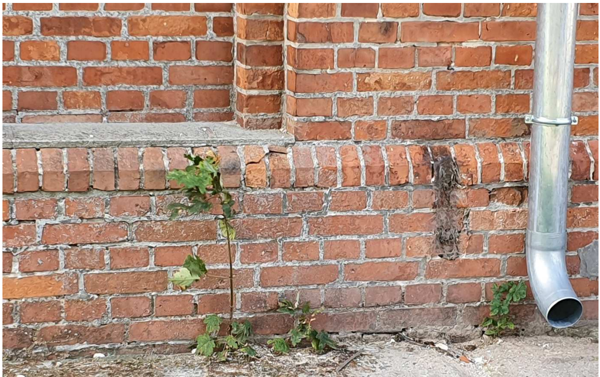
Fot.6. Łążyn, kościół pw. św. Walentego. Fragment wątku ceglanego w partii cokołowej. Na zdjęciu widoczne liczne płytkie złuszczenia lica.
