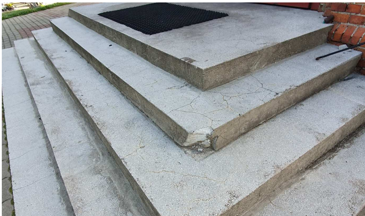
Fot.13. Łążyn, kościół pw. św. Walentego. Schody kruchty zachodniej. Widoczne spękania i odspojenia zaprawy górnych stopnic.
