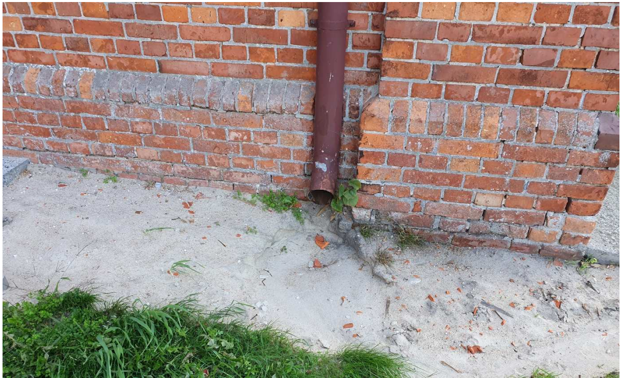
Fot.11. Łążyn, kościół pw. św. Walentego. Sposób odprowadzenia wody opadowej. Ujścia rur spustowych znajdują się zbyt blisko elewacji i sprzyjają zawilgacaniu przyziemia.
