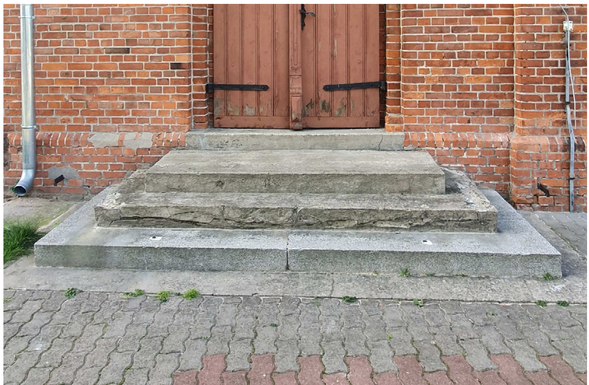
Fot.12. Łążyn, kościół pw. św. Walentego. Schody kruchty bocznej. Widoczne spękania i odspojenia zaprawy górnych stopnic.
