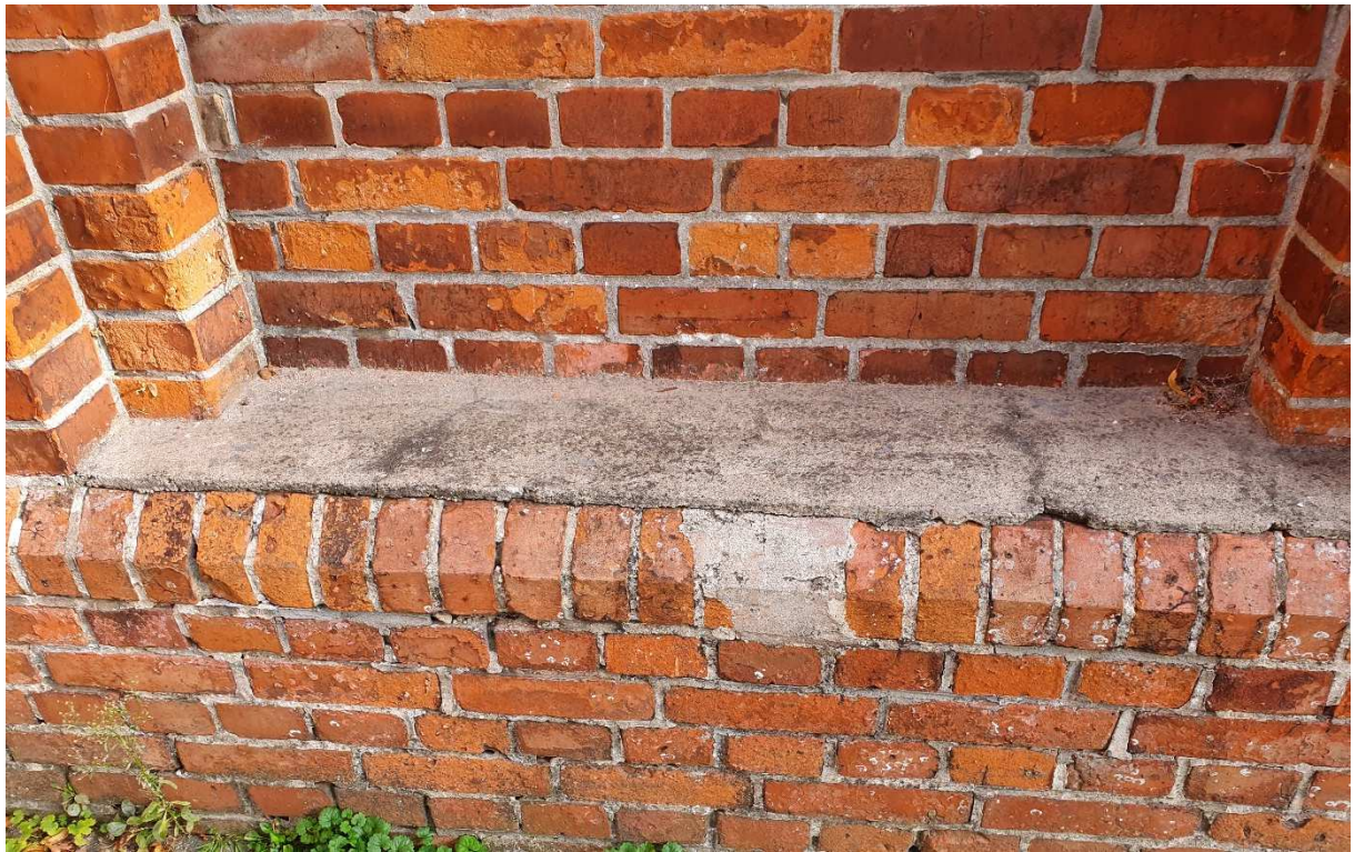
Fot.5. Łążyn, kościół pw. św. Walentego. Fragment wątku ceglanego w partii cokołowej. Na zdjęciu widoczne liczne płytkie złuszczenia lica.
