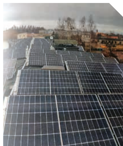
Najnowszy nabytek wspólnoty – panele fotowoltaiczne na dachu budynku
