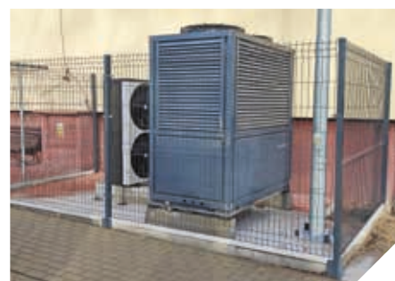
Wentylatory pompy ciepła
