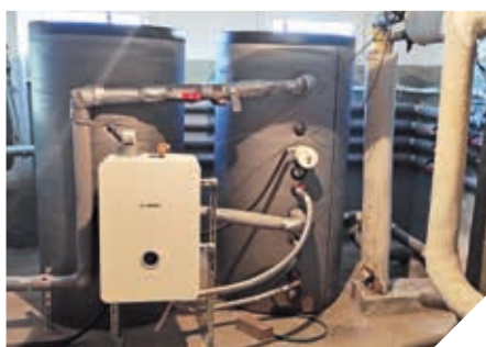
Urządzenia ciepłownicze w piwnicy bloku
