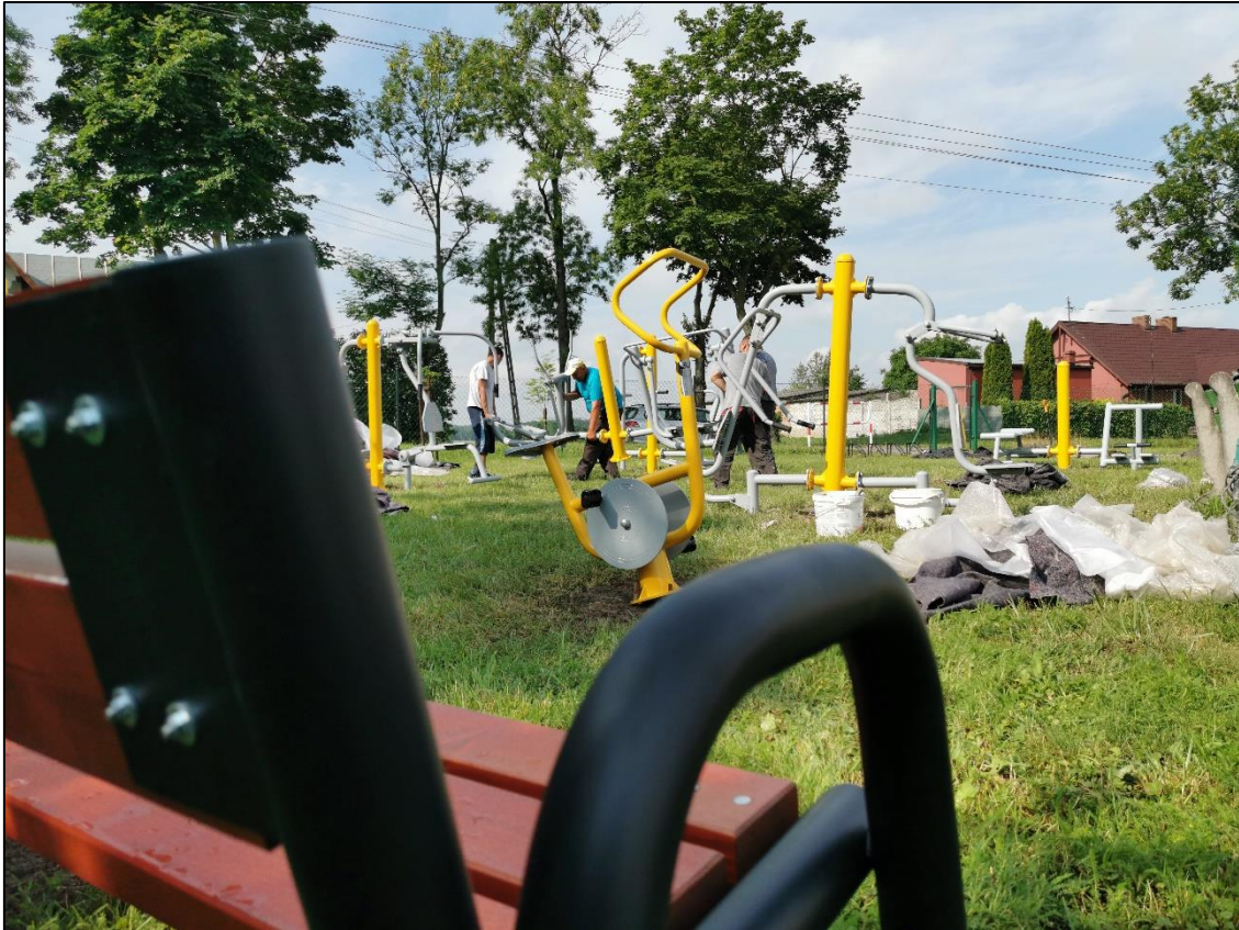
21.06.2019 r. – budowa jednej z trzech Otwartych Strefy Aktywności w Rajkowach (pozostałe powstały w Małych Walichnowach i Pelplinie)
