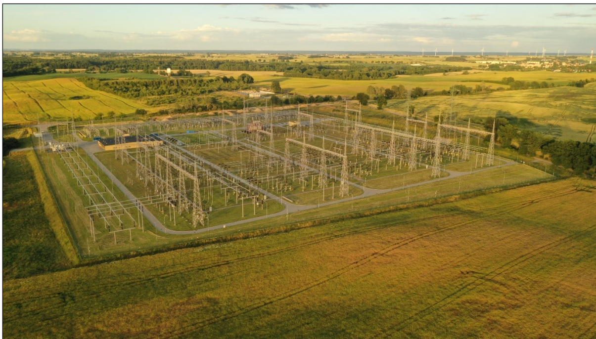
Zdjęcie 3. Główny Punkt Zasilania na terenie Gminy Pelplin
