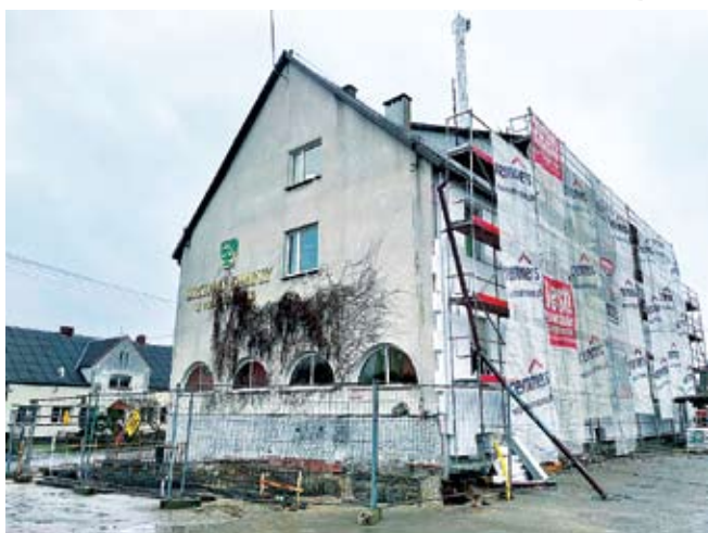
Budynek Urzędu Gminy Malechowo od czasu jego wybudowania w latach 80-tych nie przechodził gruntownego remontu.
