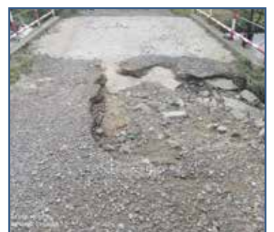
Zniszczony most w m. Mąkolin
