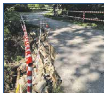
Zniszczony przepust i droga w Borowicach
