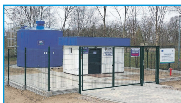
Pompownia wody w Nowym Kanigowie
