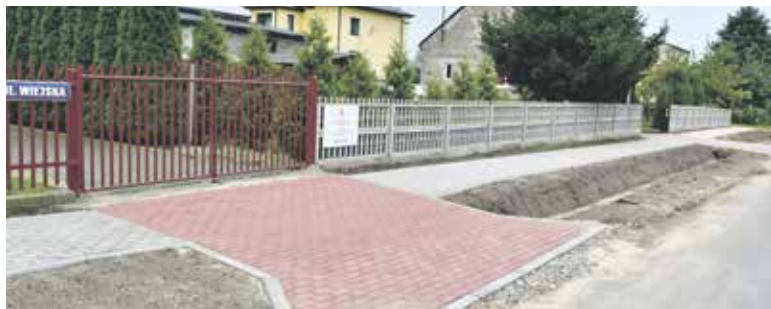
Chodnik w m. Chodkowie ul. Wiejska
