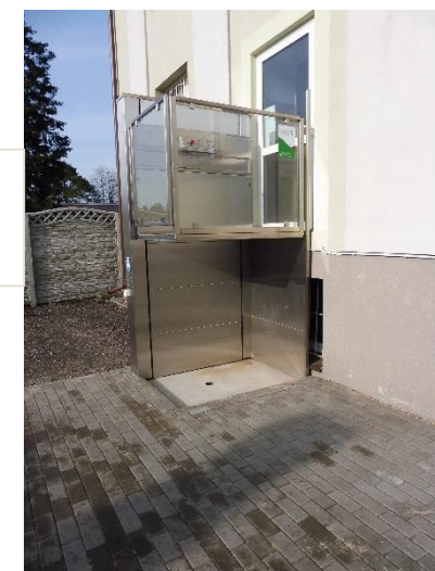
Winda przyścienna w budynku przy ul. Brokowskiej 37
