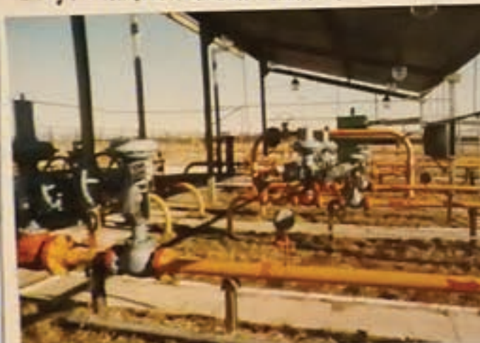
Mieszalnia Gazu - CIĄGI GAZOWE widok z boku...
