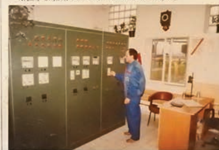
SZAFKA STEROWNICZA Z APARATURĄ KONTROLNO - POMIAROWĄ.
