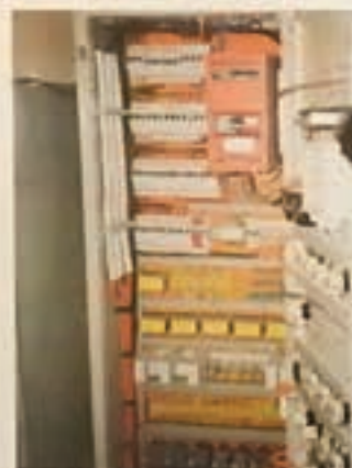
"SERCE" UJĘCIA WODY - ELEKTRONICZNY SYSTEM STEROWANIA
