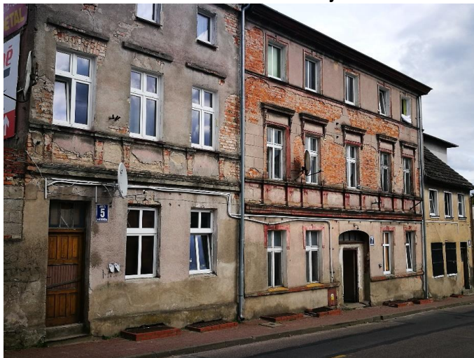
Rysunek 53. Zniszczona kamienica w obszarze rewitalizacji
