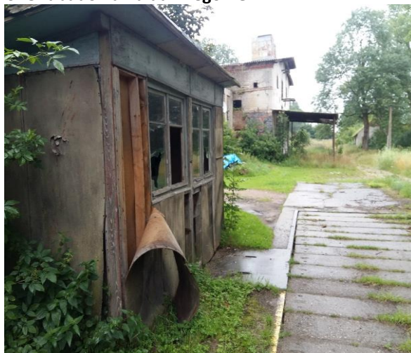
Rysunek 18. Zniszczone zabudowania dawnego PGR
