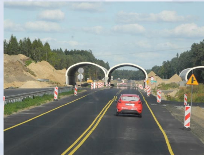
Tunnel für Wildwechsel bei Gollnow/Goleniów
